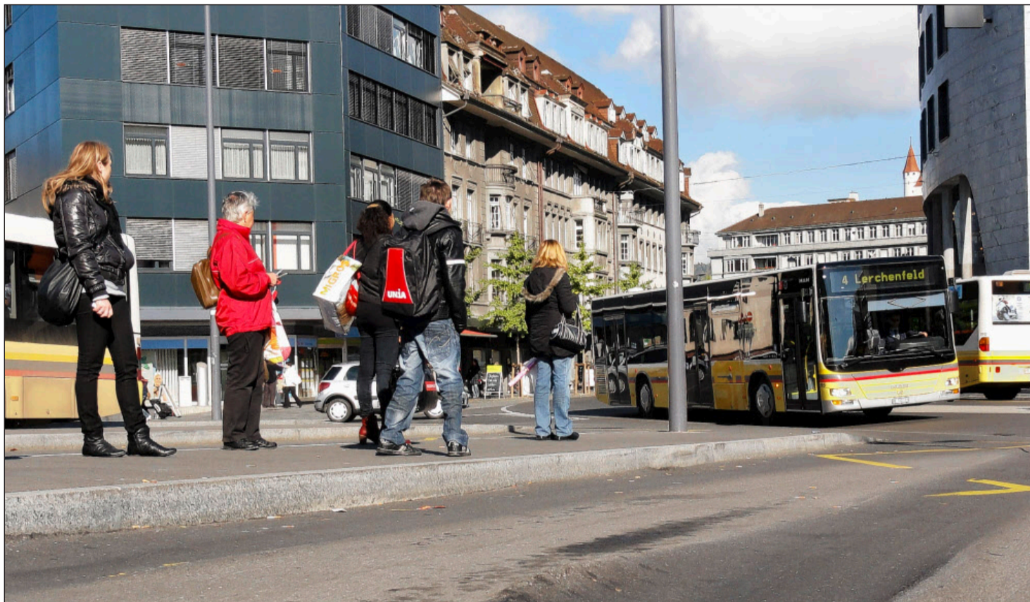
Ein Bus der STI biegt am Busterminal beim Bahnhof Thun auf die Spur zwischen Perron 9 und 10 ein. Durch die starke und regelmässige Belastung und die Hitze des vergangenen Sommers weist der Spurbelag tiefe Rinnen auf.
